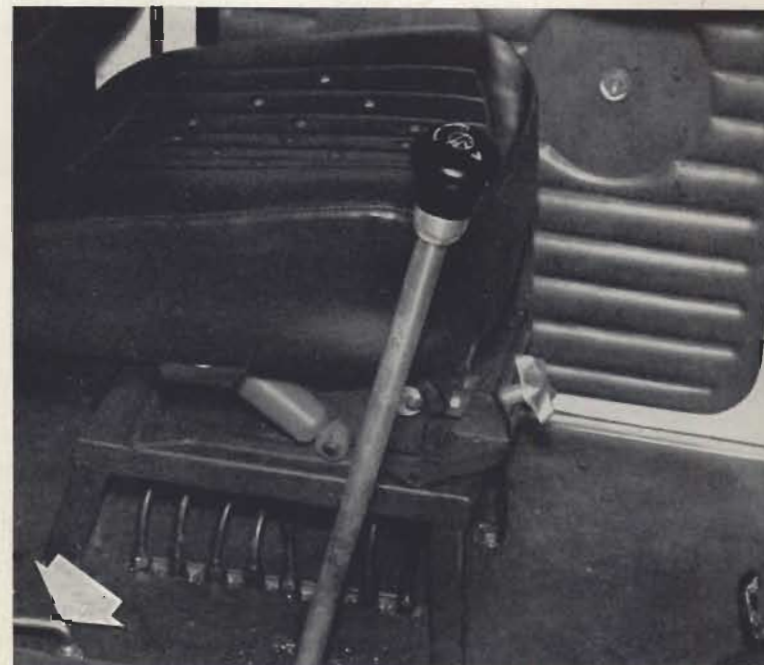
Fig. 1.9. - Interruptor general baterías
