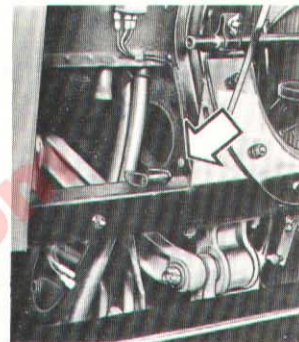
PULSADOR DE ARRANQUE EN FRONTAL DE CABINA
